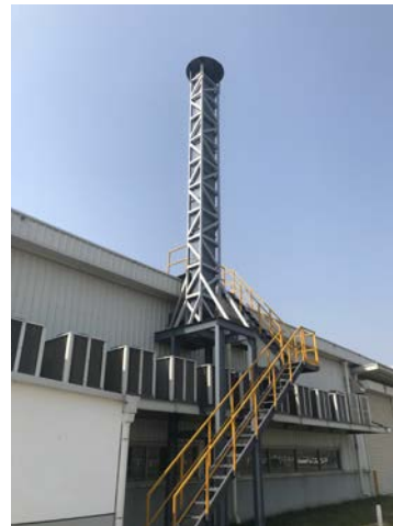
15m 高排气筒
